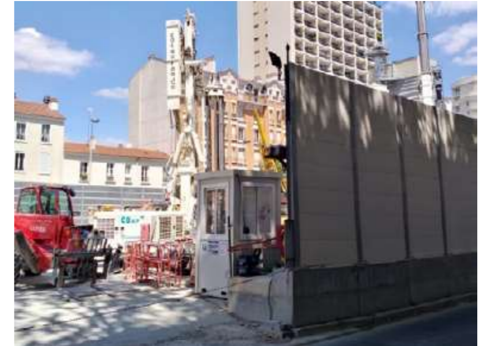
Figure 206 : Exemple d'écran absorbant provisoire mis en œuvre en limite d'emprise du chantier (Acoustb)
