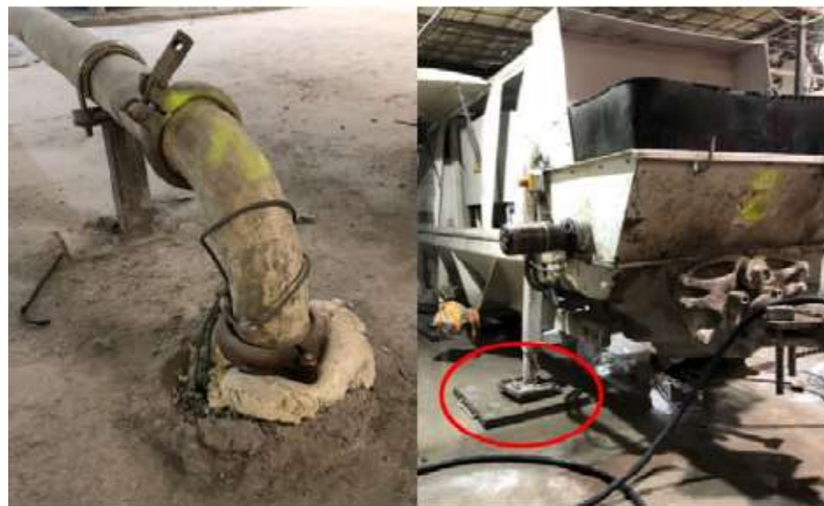
Figure 212 : Exemple de mesures : utilisation de petits compacteurs, désolidarisation d'une conduite, mise en œuvre d'un résilient pour équipement lourd ( Acoustb)
