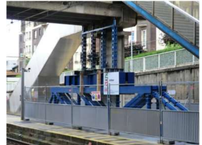
Figure 211 : Bâti équipé d'un système de vérins pour contrôler les tassements (Tramway T6 à Vélizy) (EGIS, 2021)
