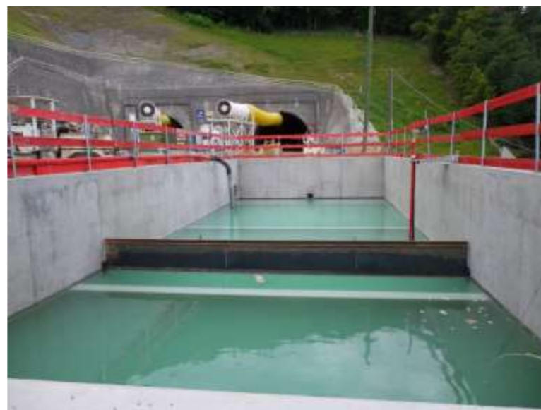
Figure 203 : Exemple d'un bac de décantation et de traitement des eaux en sortie de tunnel (EGIS)
