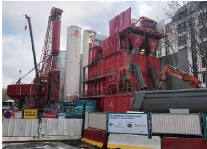
Figure 204 : Exemple de bâches installées en périphérie d'un engin bruyant situé en hauteur (Acoustb)
