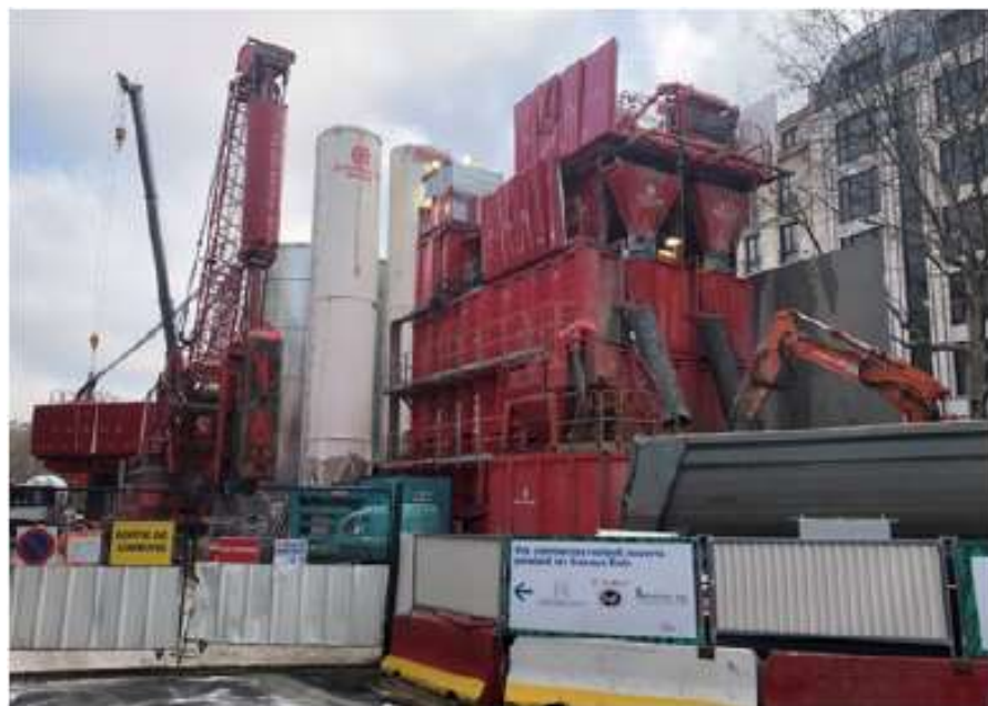
Figure 83 : Exemple de bâches installées en périphérie d'un engin bruyant situé en hauteur (Source : Acoustb)
