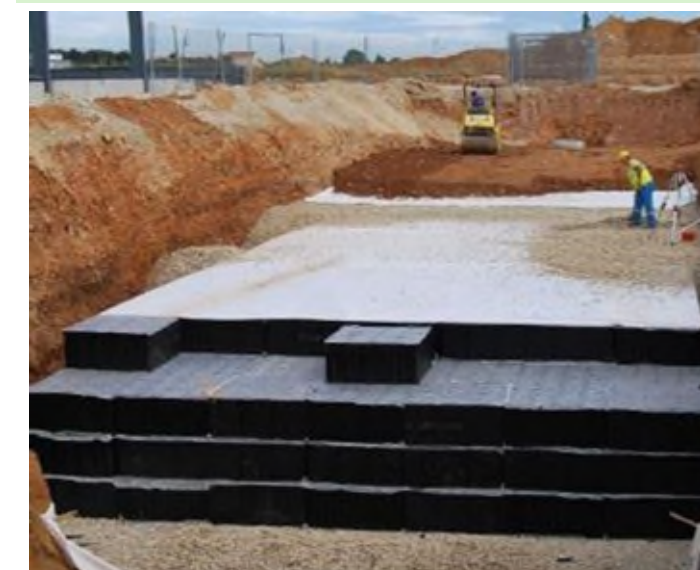
Figure 57 : Exemple de bassin enterré en cours de réalisation, ici de type SAUL (source : Nidaplast)
