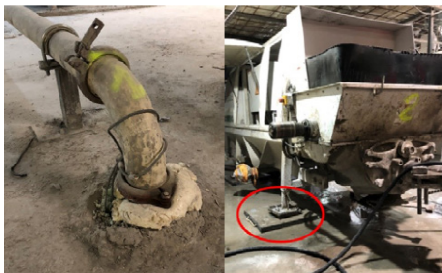
Figure 157 : * Exemple de mesures : utilisation de petits compacteurs, désolidarisation d'une conduite, mise en œuvre d'un résilient pour équipement lourd (Source : Acoustb)
